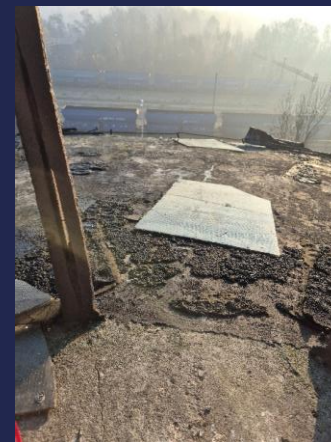
Fot. 18 – 19 Konstrukcja i deskowanie płyty dachowej – widoczne zacieki z dachu oraz stan pokrycia dachowego.
